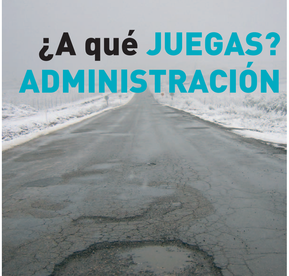
Socavones en el firme
