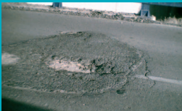
Ante la Jefatura Provincial de Salamanca el mal estado de conservación de la carretera N-620.
